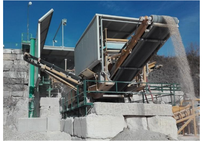
FOTO 2 - Schermatura antirumore sul lato ovest e superiore alla zona di selezione granulometrica
