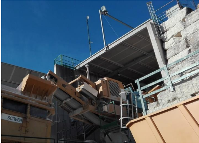
FOTO 1 - Schermatura antirumore sopra il frantoio
