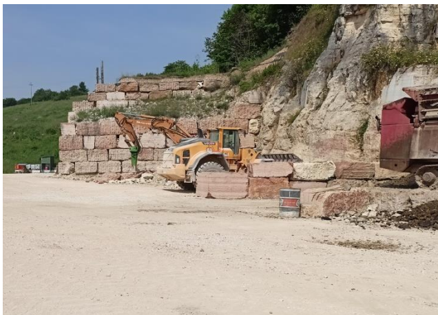
FOTO 3 - Barriera in massi e parete rocciosa sui fronti ovest e nord della zona di lavorazione con martellone
