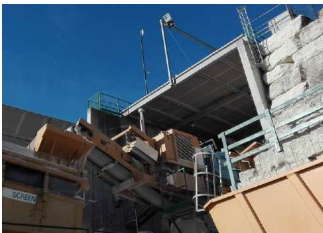
FOTO 1 – Schermatura antirumore sopra il frantoio
