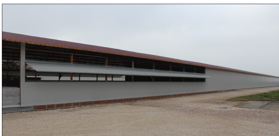
Figura 40: Particolare delle finestre a vasistas, prima del posizionamento del cooling, in un'azienda simile
