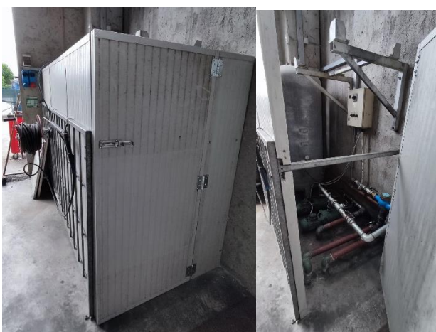
Foto zona pompa per emungimento idrico
