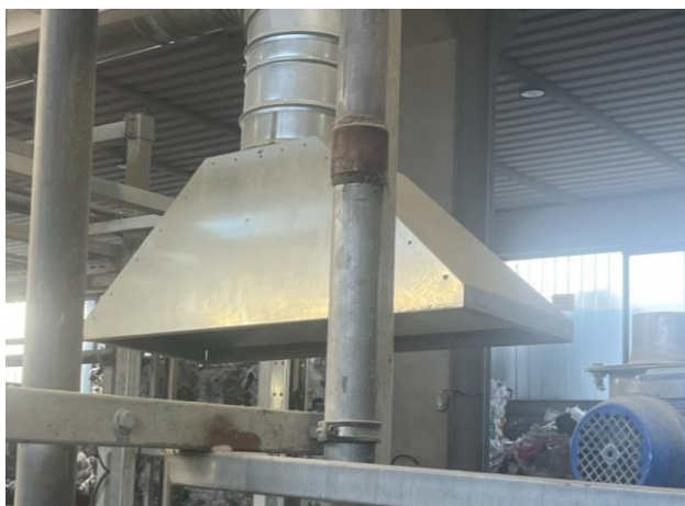
Foto cappa terminale pre-intervento (1000x400)
