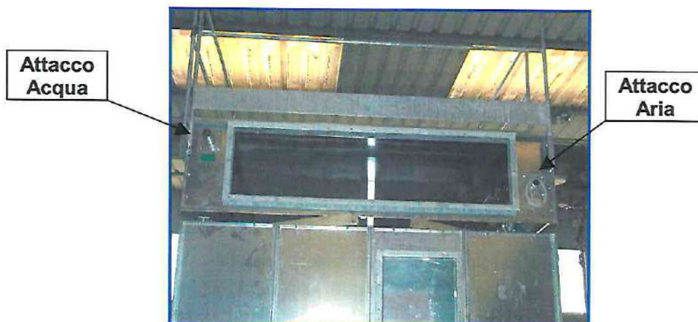
Collegamenti pneumatico ed idrico del filtro.
