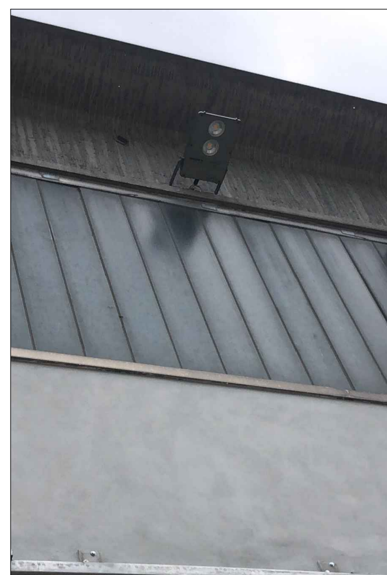
PROIETTORE INGRESSO CAPANNONE (ACCESO DURANTE TUTTO IL PERIODO NOTTURNO) Altezza apparecchio 7,2 mt
