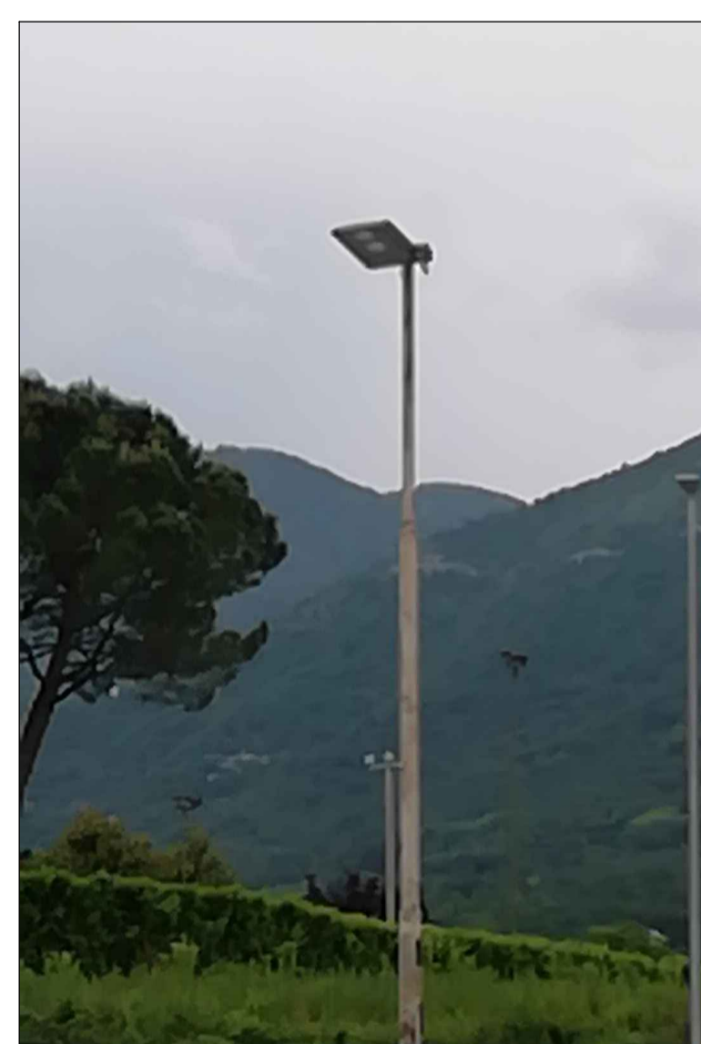
PROIETTORE INGRESSO IMPIANTO (ACCESO SOLO DURANTE L'ATTIVITA' LAVORATIVA)
