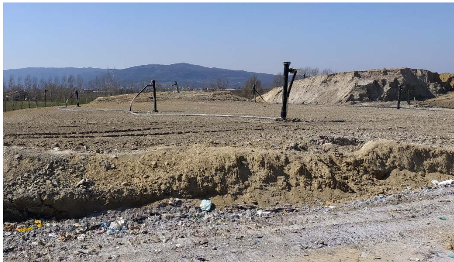
Rete di pozzi di captazione del biogas
