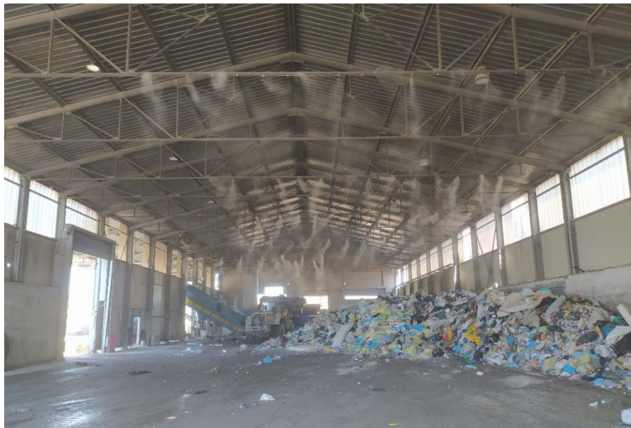
Impianto di umidificazione dell'area ricezione e pretrattamento rifiuti
