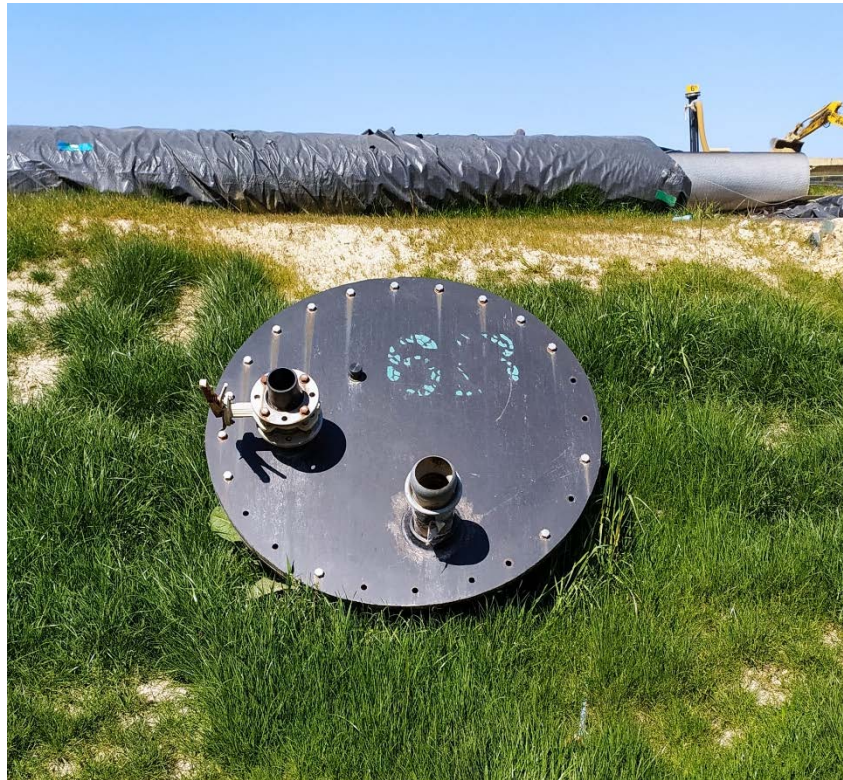
Pozzetti di raccolta dei percolati
