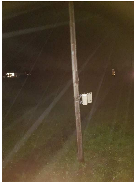
Collocazione del dispositivo contatraffico
