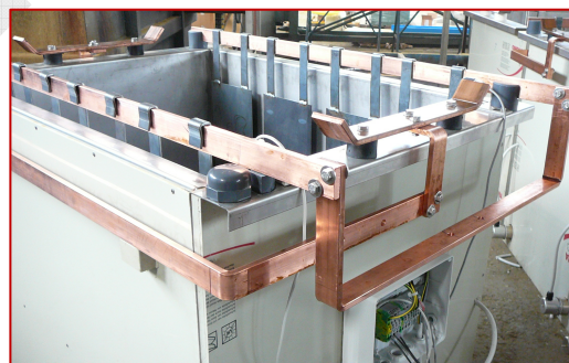
Armatura vasca di sgrassatura elettrolitica
