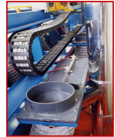
Vista serranda automatica per aspirazione dal carrello
