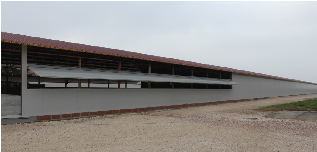
Particolare delle finestre a vasistas, prima del posizionamento del cooling, in un'azienda simile
