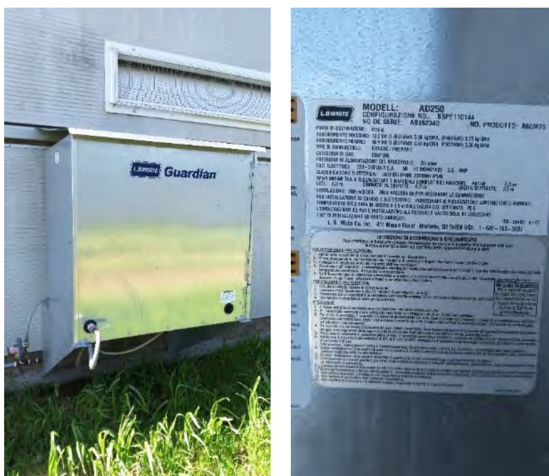
Immagini di uno dei generatori di calore (bruciatore a GPL) a servizio dei capannoni di allevamento
