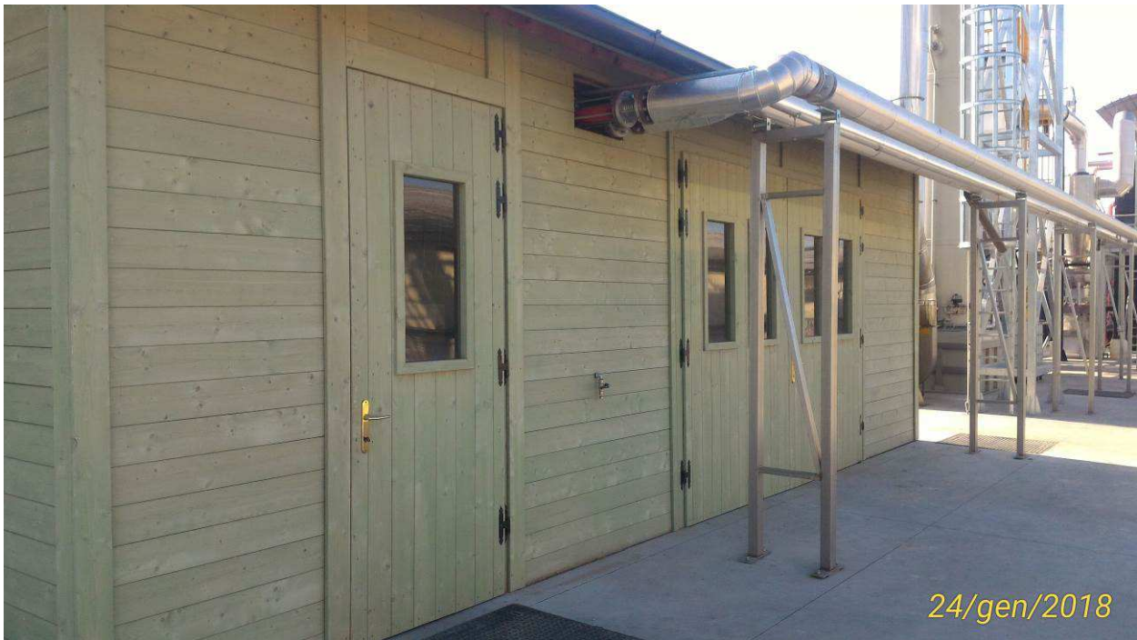
Box coibentato e contenente le turbine dell'impianto
