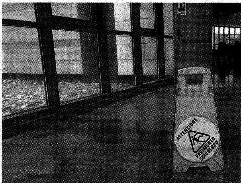
L'avviso giallo L'infiltrazione d'acqua è nel piano interrato, davanti all'aula del tribunale collegiale. Ieri un cartello giallo segnalava il problema agli utenti del foro di Vicenza
