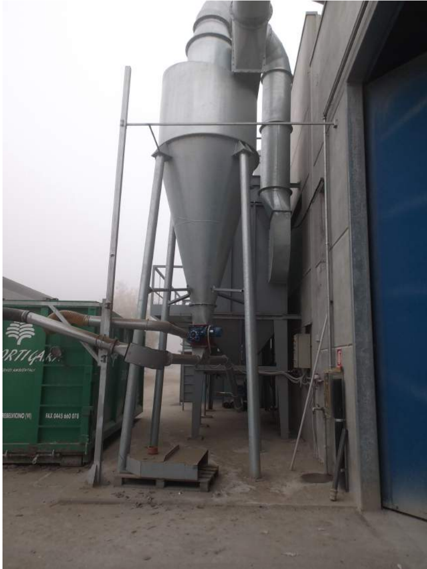
Foto 4 - Vista del ciclone e del filtro a maniche, con impianto pneumatico di raccolta polveri, presenti sulla facciata sud del capannone
