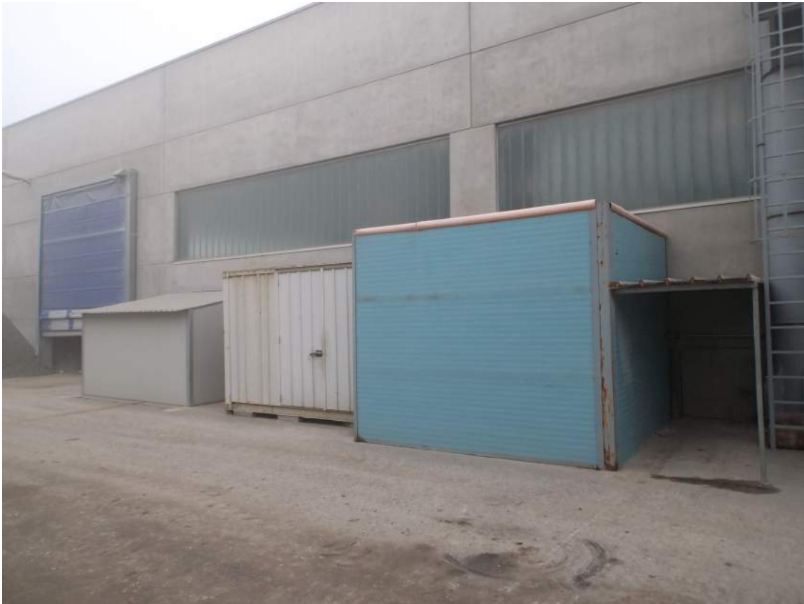
Foto 5 - Vista del generatore elettrico e del compressore, dotati di cabinamento acustico, presenti sulla facciata sud del capannone
