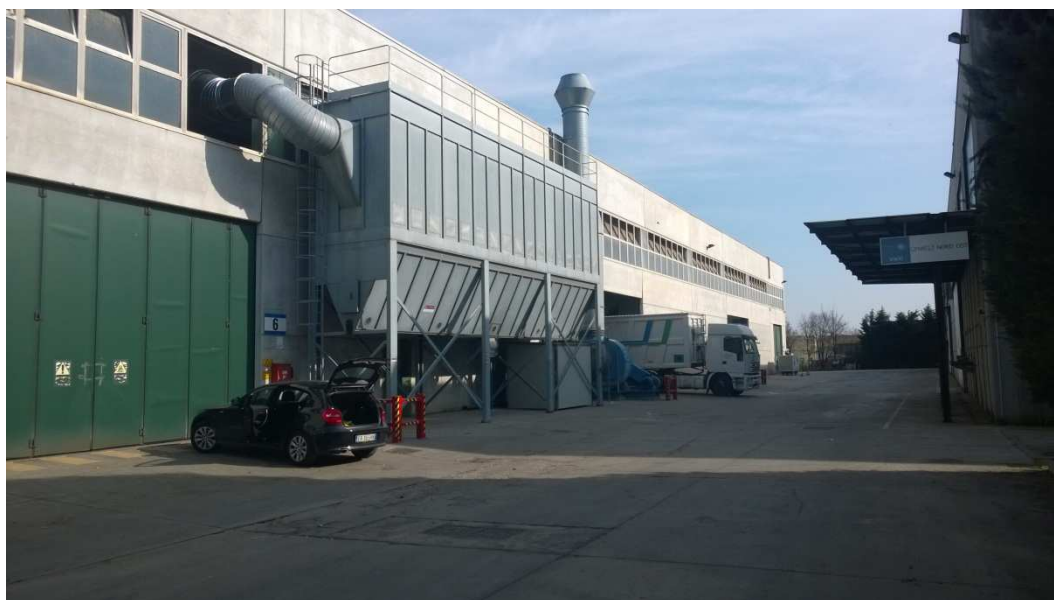
Foto 1: vista esterna dell’impianto
