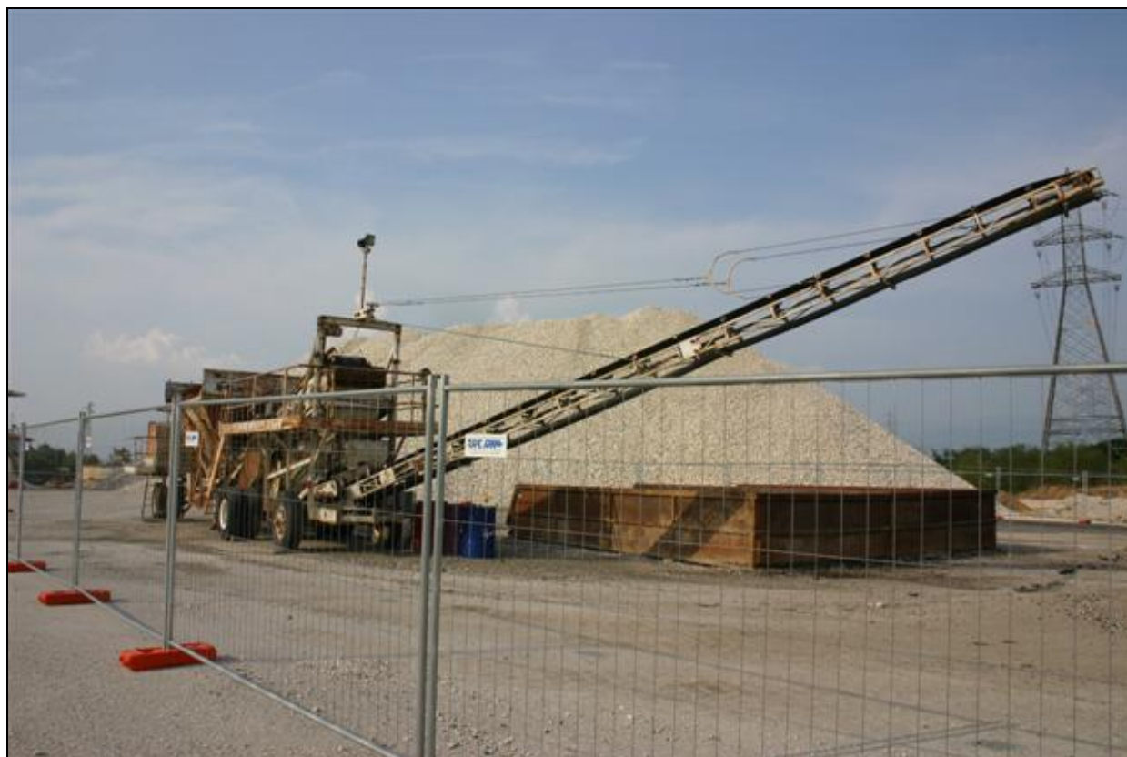
Impianto di recupero del fresato di asfalto con, sulla destra, i cassoni per lo stoccaggio del rifiuto da trattare
