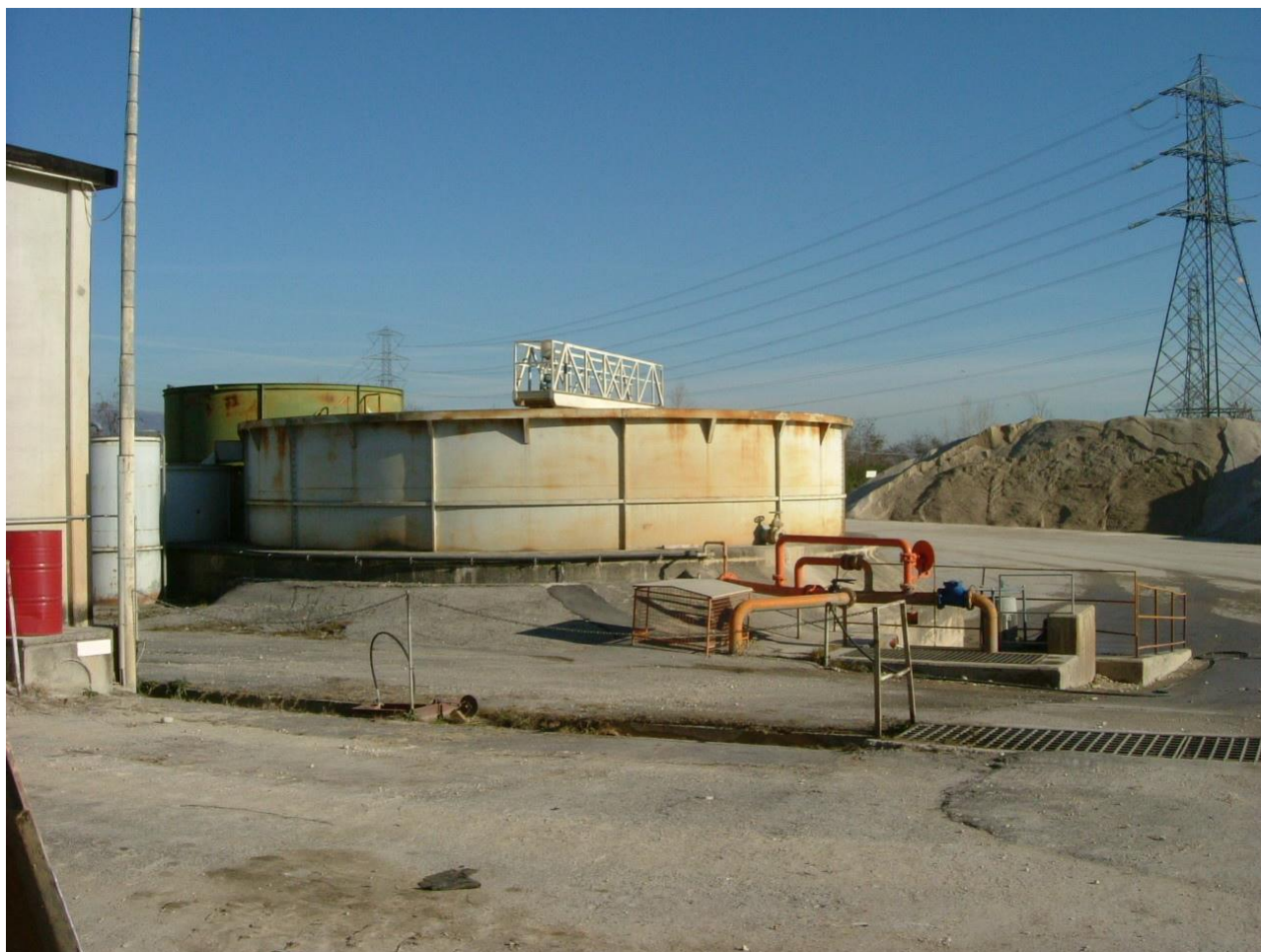
Impianto di chiarificazione delle acque con particolare della griglia di raccolta.
