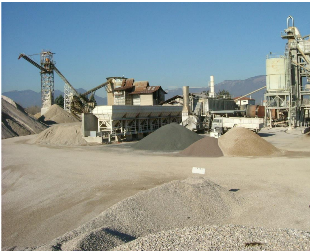
Particolare dei predosatori contenenti materiale di diversa granulometria per il confezionamento del conglomerato bituminoso.
