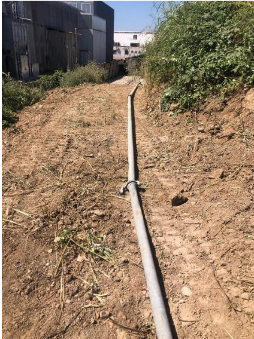
Foto 17. Tubazione di adduzione al sistema di trattamento
