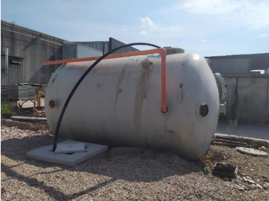
Foto 13. Cisterna per recupero acque bagnatura
